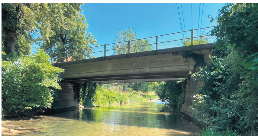
Die Sisslebrücke in Oeschgen ist in den nächsten Wochen nicht benutzbar.
